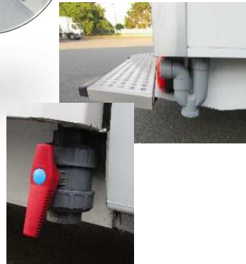
4 Wasserabläufe : 2 Siphons hinten 2 Vierteldrehungsventil vorne
